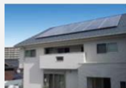
住宅用太陽光発電システム
